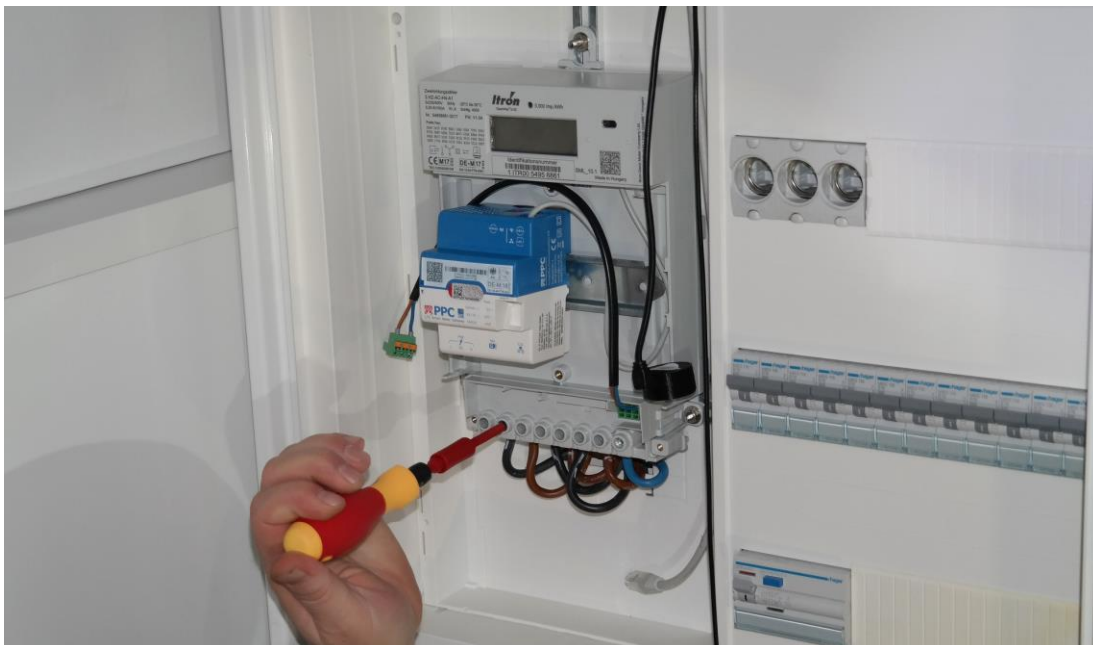
Abb. 2 Einbau des ersten zertifizierten Smart Meter Gateways
