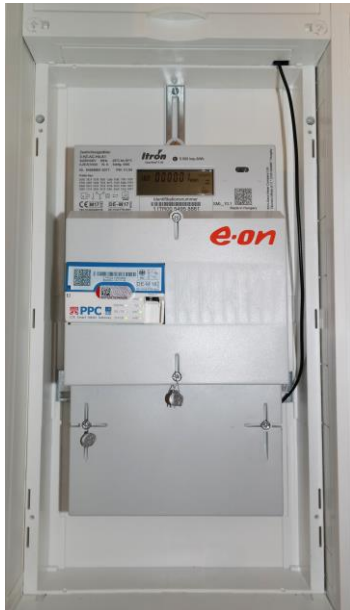
Abb. 3 Zertifiziertes Smart Meter Gateways im Betrieb
